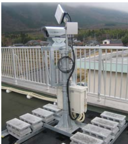
塚原小学校に設置した無線機器
