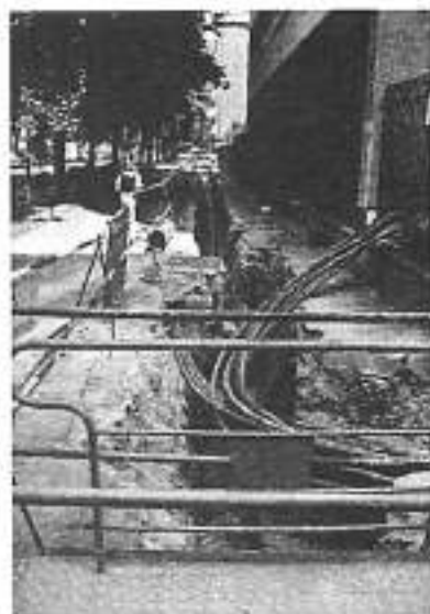
地下埋設された光ファイバ
